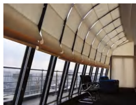
Daylighting Control 采光控制
