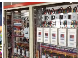
Industrial Control Cabinet 工业控制柜
